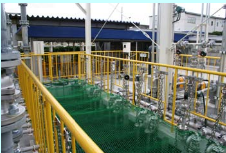
新排水処理設備
